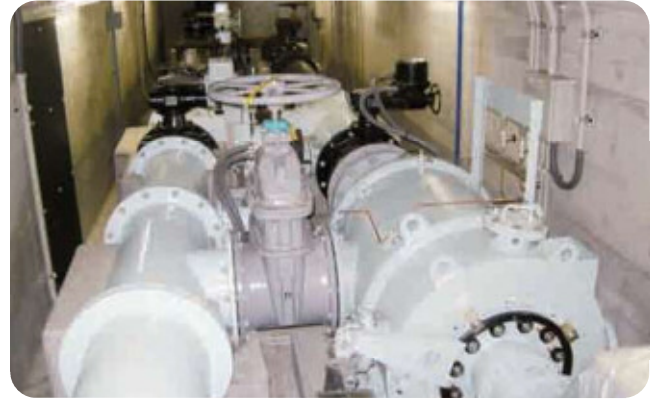
小水力発電（尾間木配水場）
