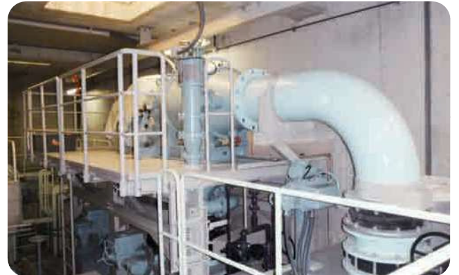
小水力発電（深作配水場）
