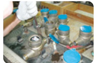
水道メーターの再資源化
