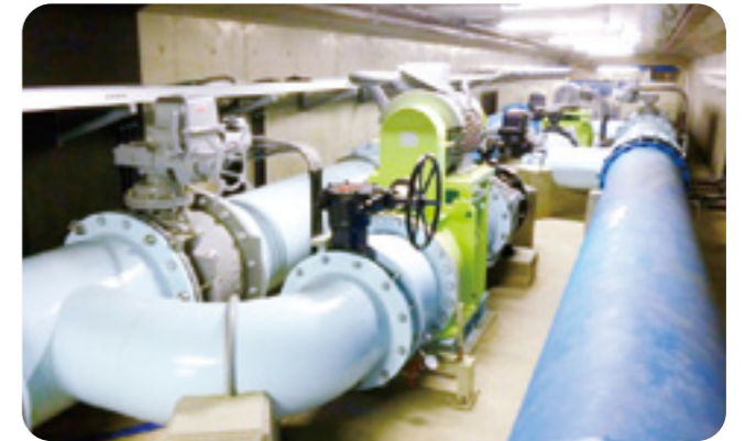
小水力発電 (北部配水場)
