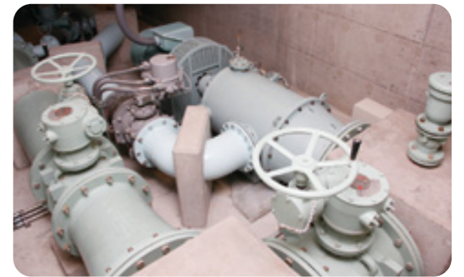
小水力発電 (大宮配水場)
