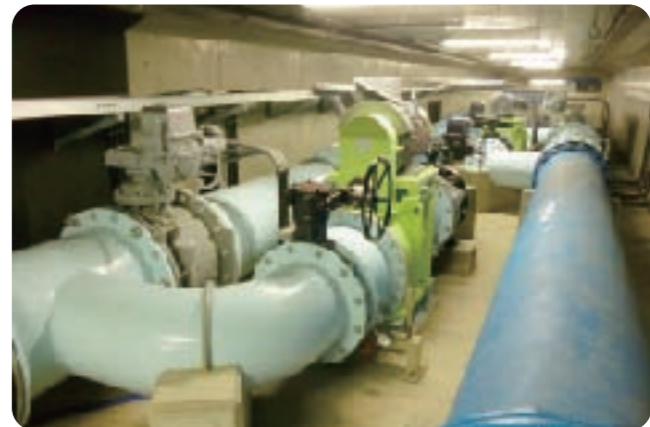
小水力発電(北部配水場)
