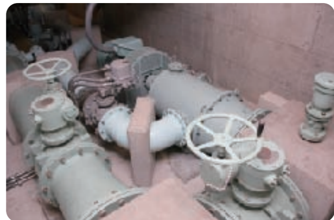
小水力発電(大宮配水場)
